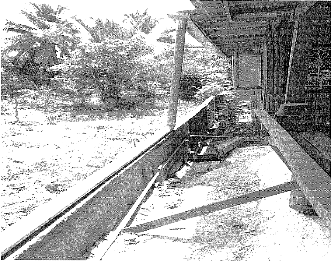
ภาพถ่ายการดำเนินการต่อปลายท่อระบายน้ำให้ยาวออกไปลงสู่พื้นดินของผู้ถูกร้อง
